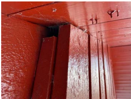
Bilde viser eksempel på åpning i kledning hvor mus kan krype inn.
