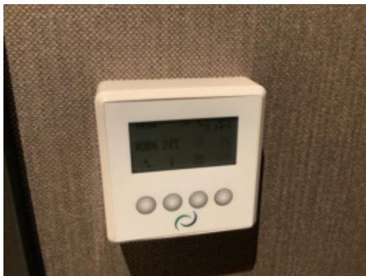
Kontrollpanel til ventilasjonsanlegget.
