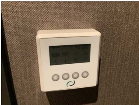
Kontrollpanel til ventilasjonsanlegget.
