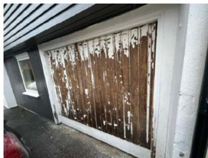
Slitasje på port samt ramme rundt port.
