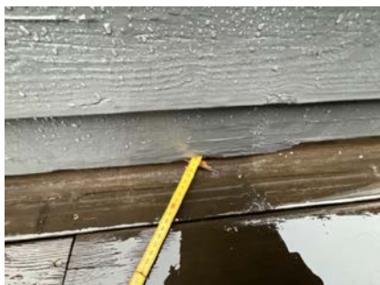
Noe mykt treverk og råte i enkelte kledningsbord.
