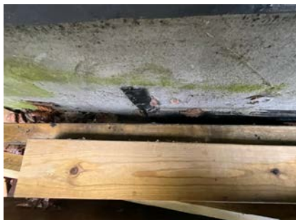
Grunnmursplast stoppet ca på midten av garsje.
