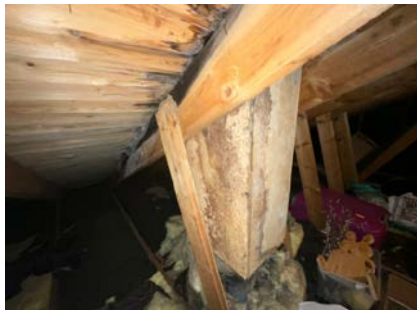
Fuktskjolder i undertak og taksperr.
