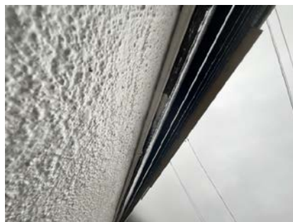
Ingen lufting i bakkant av kledning.
