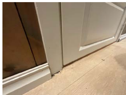
Ingen tilluftsspalte i dør.
