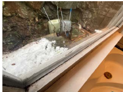
slitasje i karmen og pakninger på vinduer av eldre dato.
