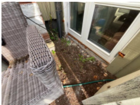
Fall mot boligens grunnmur i 1.etasje ved balkongdør.
