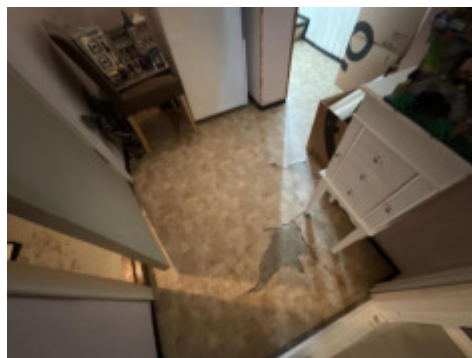
Skadet belegg i gang
