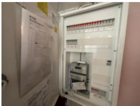
Oversikt av sikringsskap i kjeller.
