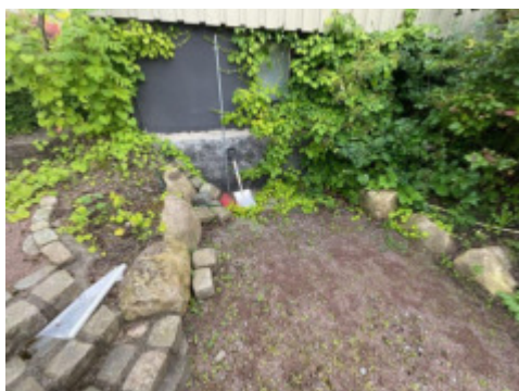
Fall mot boligens grunnmur i kjelleretasje
