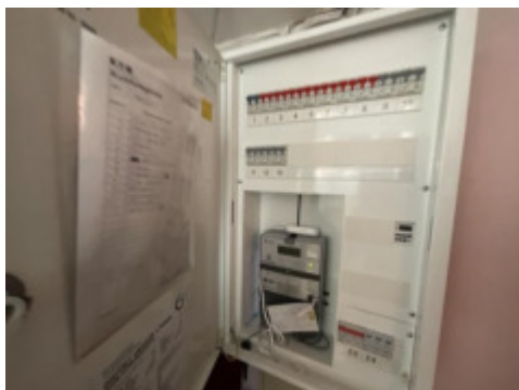
Oversikt av sikringsskap i kjeller.
