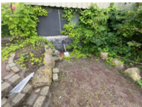
Fall mot boligens grunnmur i kjelleretasje
