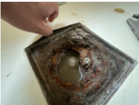
Utett rundt gulvsluk-belegg fra byggeår.
