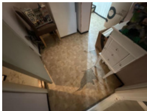
Skadet belegg i gang
