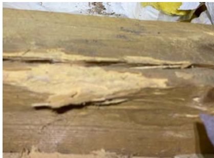
Boremel fra husbukk i deler av konstruksjonen.
