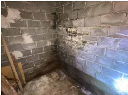
Synlig fuktvandring i tilbakefylt ytterkonstruksjon.
