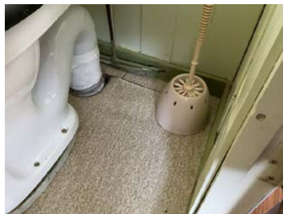
Svikt i gulv ved rørgjennomføringer.
