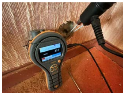
Høyt trefuktinnhold / vektprosent i innforet konstruksjon - Rom under terreng.
