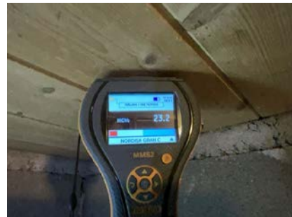
Høyt trefukttinnhold i takpanel forårsaket av høy luftfuktighet i rommet.
