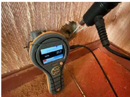
Hulltaking - Høyt trefukttinnhold / vektprosent i innforet konstruksjon.
