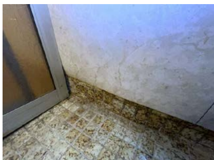
Våtromsplater med svelling / fuktskader.
