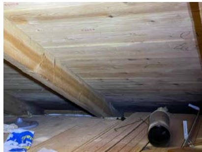
Misfarging som følge av kondensering ved takfoten.
