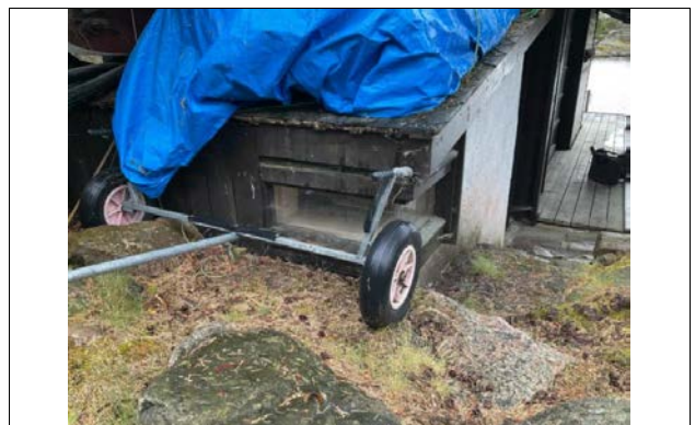
Fuktinnsig på tilbygd del mot terreng
