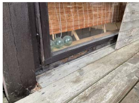
Slitsje og noe råte i karmen/vegg rundt vinduer
