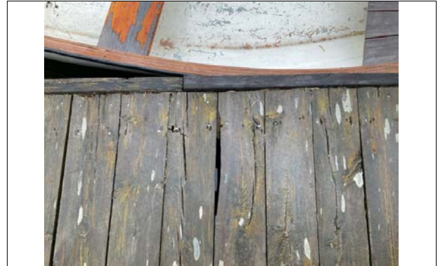
Sporadisk råte på treverk til bryggeanlegg
