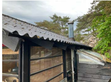
Ikke montert takrenner på sjøbu
