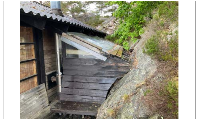
Tilbygd del mot fjell med ufagmessig utførelse/løsninger. Modent for riving
