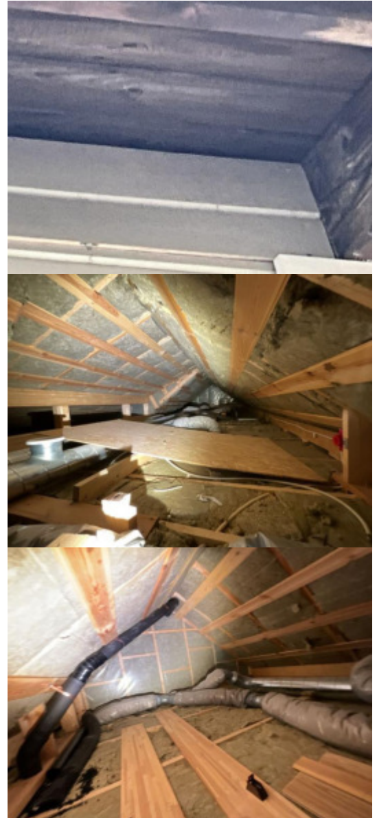
Foto viser musefelle og gnagemerker på rørisolasjon.
