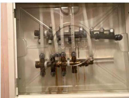
Foto viser bilde tatt i 2024 som viser rustvann i skap. Rørlegger skal ha stanset årsak til dette iflg. leietaker.
