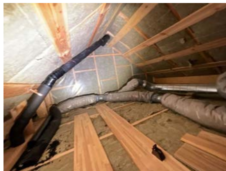
Foto viser musefelle og gnagemerker på rørisolasjon.
