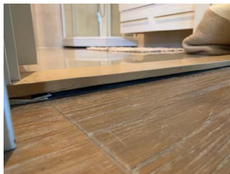
Synlig glippe/avvik under dørterskel til badet i underetasjen
