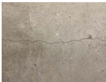
Enkelte mindre sprekker i betong-gulvet i garasjen.
