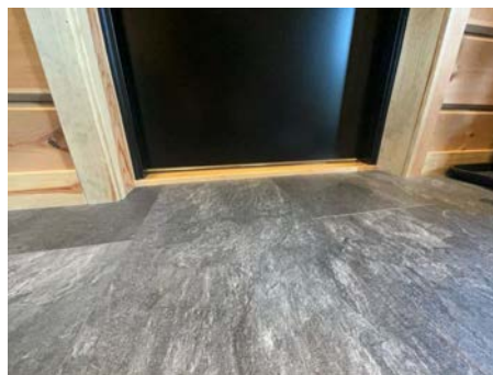
Spalte under dør.
