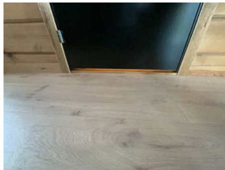
Spalte under dør.
