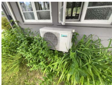
Varmepumpe utvendig komponent.
