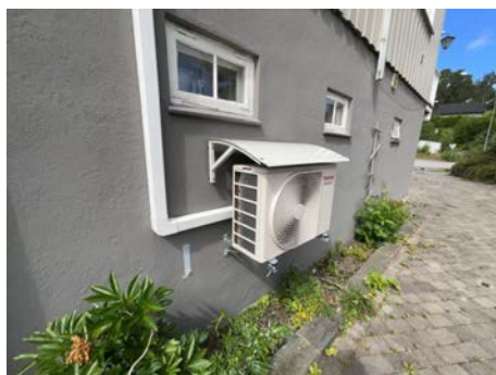
Varmepumpe utvendig komponent.
