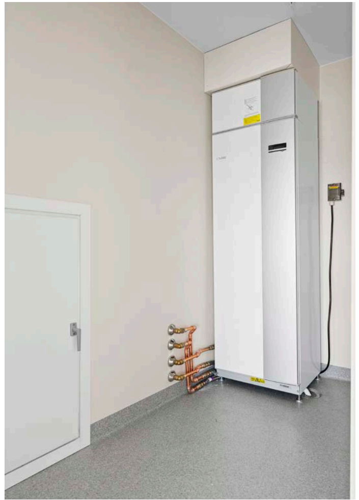
Varmepumpe på teknisk bod
