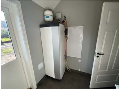
Anlegg for vannbåren varme plassert på vaskerom.
