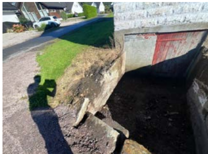
Sprekk og skade på mur.
