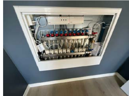
Vannskap med vannledninger plassert på soverom.
