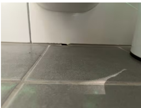
Drens hul for eventuell lekkasje på sistene fra toalettet.
