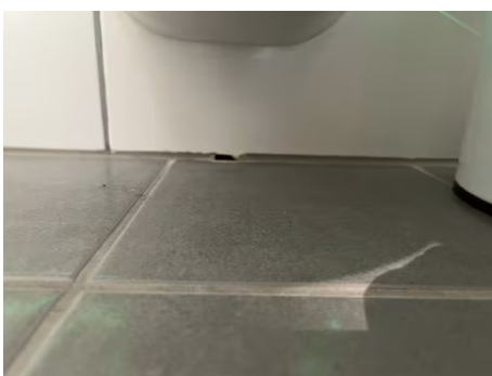
Drens hul for eventuell lekkasje på sisterne fra toalettet.
