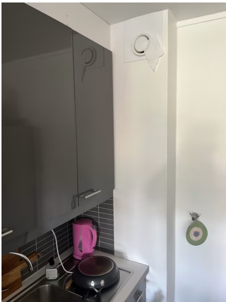
Avtrekk i fra rommet inn i felles lufte sjalt.
