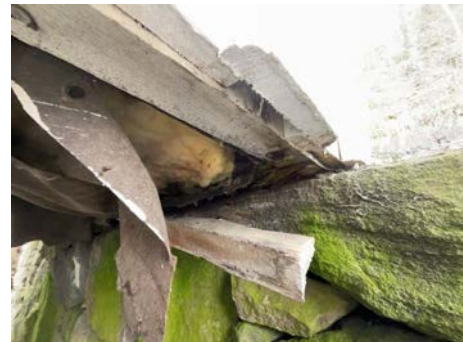
Skillekonstruksjon med råteskader under den tilbygde delen.
