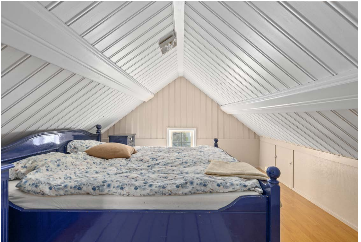
Rom som benyttes som soverom i loftsetasje (ikke tilfredsstillende rømningsvei)
