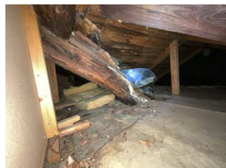
Råteskadet del av takkonstruksjon - Ved pipe.
