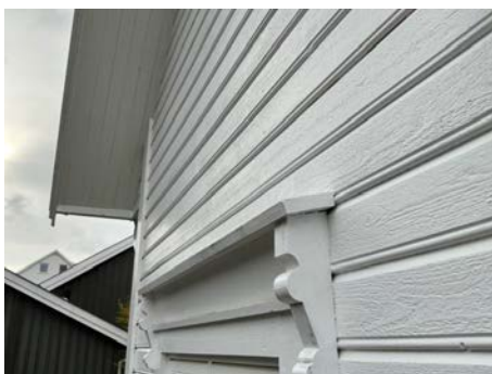
Vannbord ikke felt inn bak kledning.
