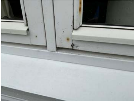
Begynnende dårlig treverk og rust.
