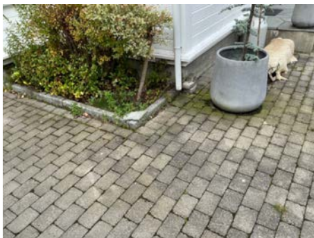
Nedløp anbefales ledet bort med utkaster.
