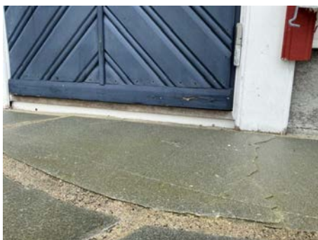
Noe begynnende dårlig treverk anneks dør.
