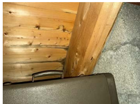
Eldre fuktskjolder rundt pipe.
