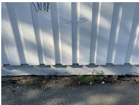
Stedvis enkelte bordganger med sprekk/råte i nedre del.
