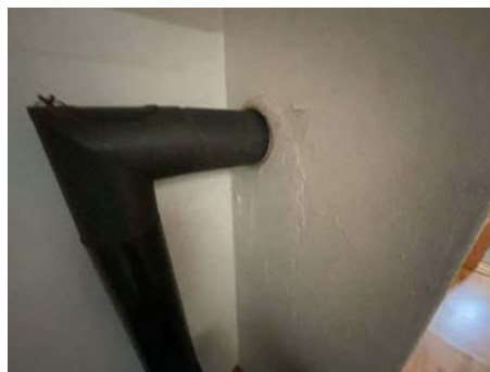
Sprekker rundt røykrørsføring. TG 2
