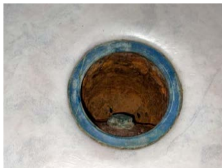
Klemring i støpejerns sluk er ikke tett.
