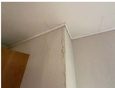
Tegn etter eldre lekkasje
