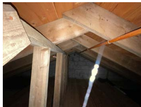
Ingen svekkelser som følge av senter bæring er noe forskjøvet.
