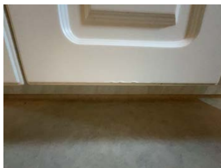
Svelling på innredning.
