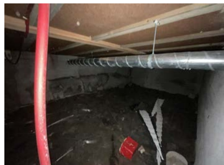
Krepkjeller under stue/soverom ses det større fuktskjolder på grunnmur mot hage,
