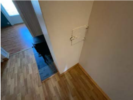
Ingen ildfast plate på gulv under sotleuke. TG 2
