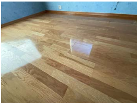
Parkett er slip opp tidligere og kan trolig ikke slipes ytterligere.
