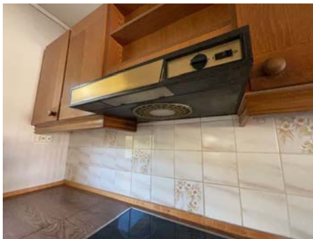
Eldre ventilator med lite trekk og defekt lys
