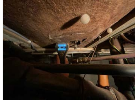
Stubbloftsplater ses med større fuktskader og det er noe fuktavvik i disse.
