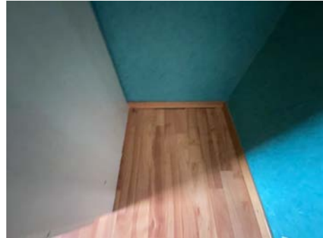
Noe mangelfull avslutning på gulv/lister
