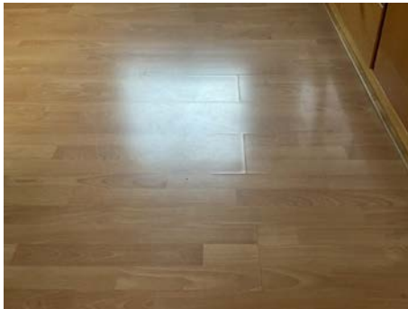
Fuktskjolder på gulv
