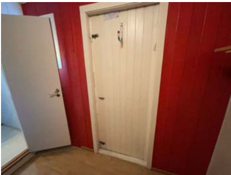
Innvendig oversikt av bod dør - døren er ikke tett.
