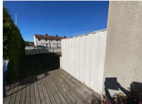
Plattning mot vei - ukjent om denne er godkjent.
