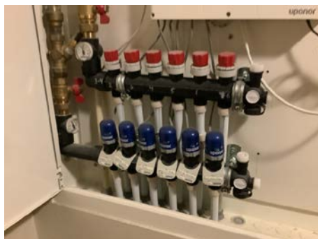
Kontrollskap for vannbåren varme.
