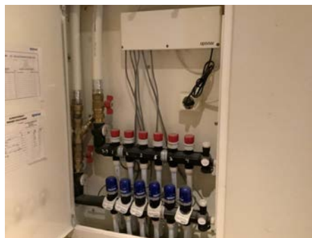
Kontrollskap for vannbåren varme.
