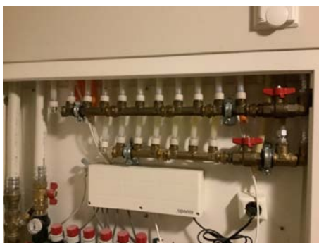
Røropplegg i kontrollskap.
