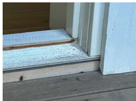
Balkongdør -mangler beslag
