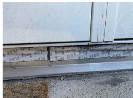
Ytterdør -dårlig tilpasset beslag
