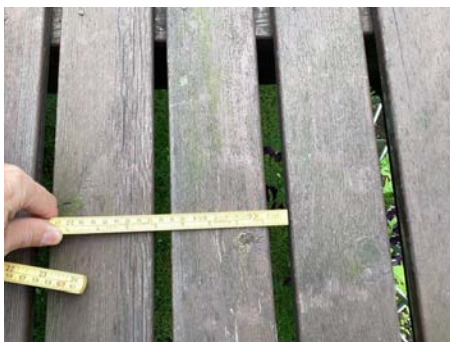
Store åpninger mellom bord
