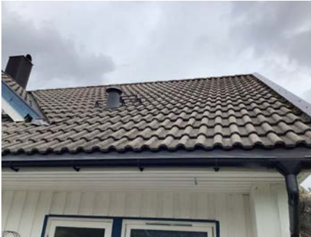
Taket har ikke snøfanger
