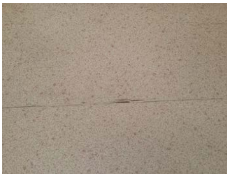
Skade i beleggsjøt
