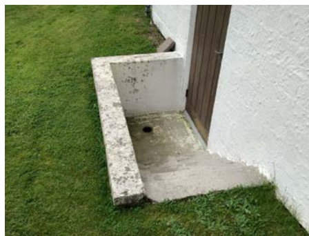
Trapp mangler rekkverk
