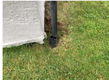
Skade på overgang nedløp / terreng
