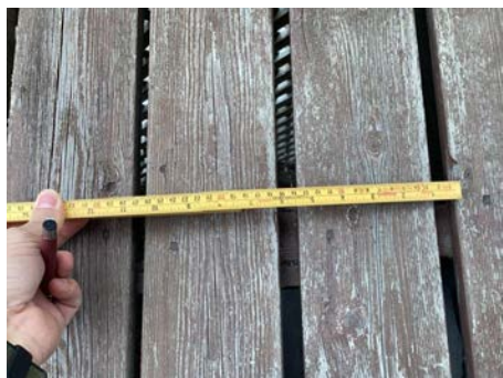
Store åpninger mellom bord
