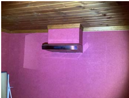
Avtrekksvifte i bod
