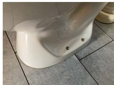
Skader på laminat ved toalett
