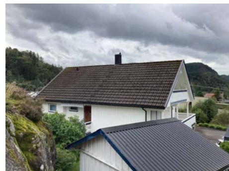
Taket har ikke snøfanger
