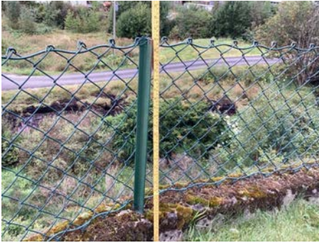
Rekkverk er lavere enn dagens krav
