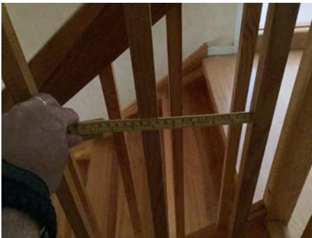
Åpninger i rekkverk er større enn dagens forskriftskrav til rekkverk i trapper.
