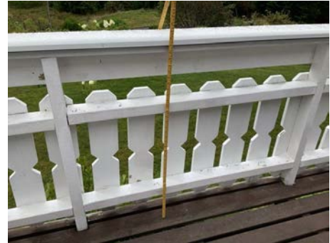
Rekkverk lavere enn dagens krav.
