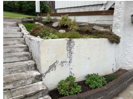
Sprekk i overflate / mur har ikke rekkverk
