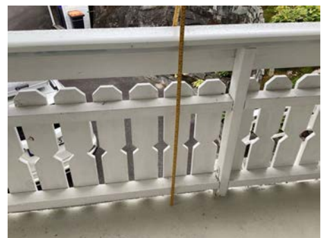
Rekkverk lavere enn dagens krav.
