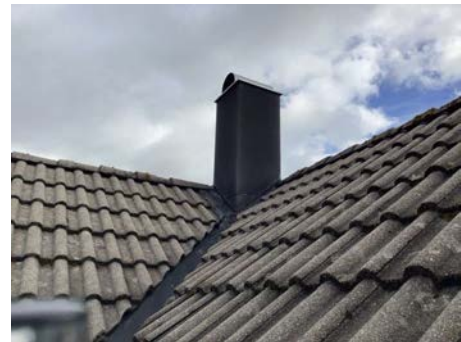
Rust på pipehatt
