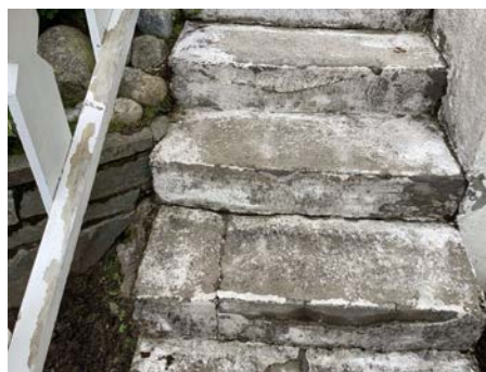
Sprekker i trinn
