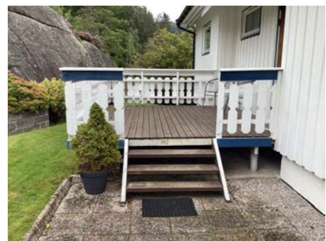
Trapp mangler rekkverk
