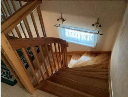
Håndløper mangler i trapp
