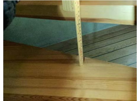
Åpninger mellom trinn i innvendig trapp er større enn dagens forskriftskrav.
