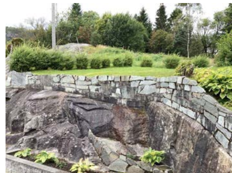
Mur har ikke rekkverk
