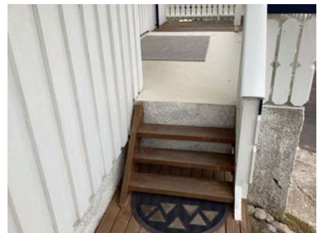
Trapp har ikke håndløper på vegg
