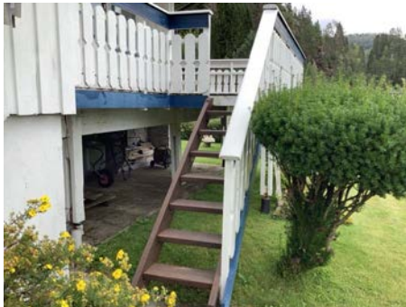
Rekkverk mangler i trapp
