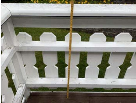
Rekkverk lavere enn dagens krav.
