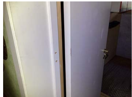
Mindre skade på boddør
