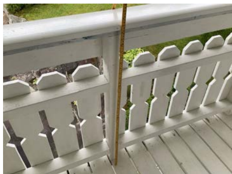
Rekkverk lavere enn dagens krav.
