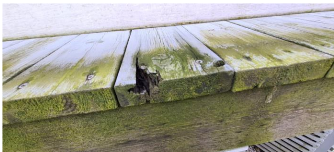
Råte skade terrassebord
