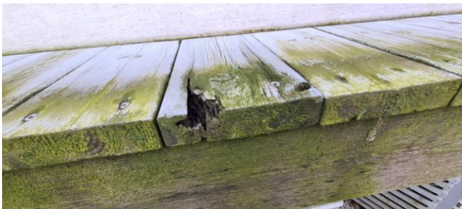
Råte skade terrassebord
