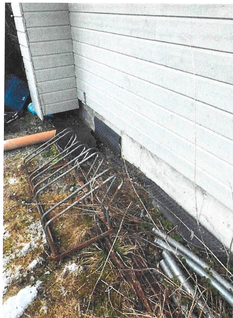
Ikke klemlist på Platon grunnmursplast.
