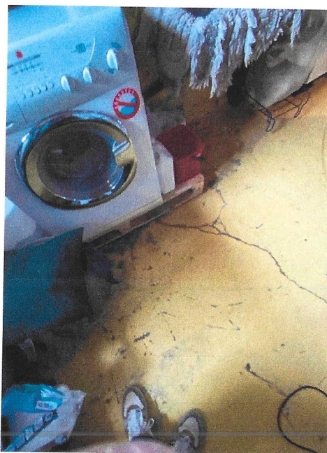
Vaskerom med sprekker i gulv. Gulv er ikke vanntett.
