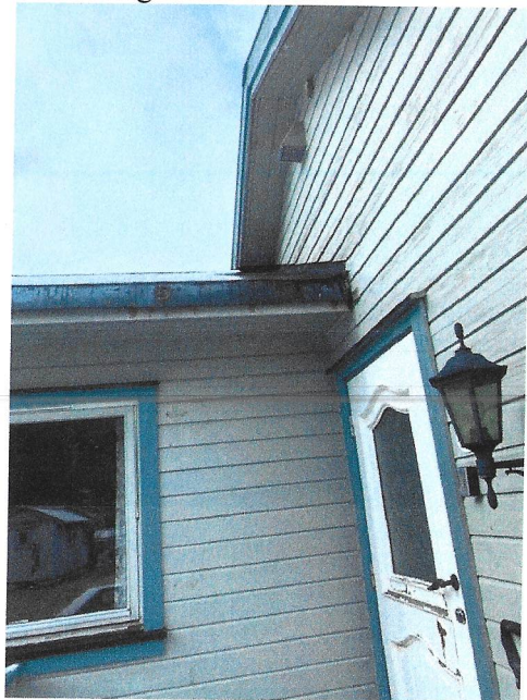
Eks på manglende takrenne
