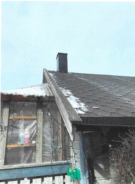
Taktekking, vannbord og vindskier. Ufagmessig bygd tak over veranda.
