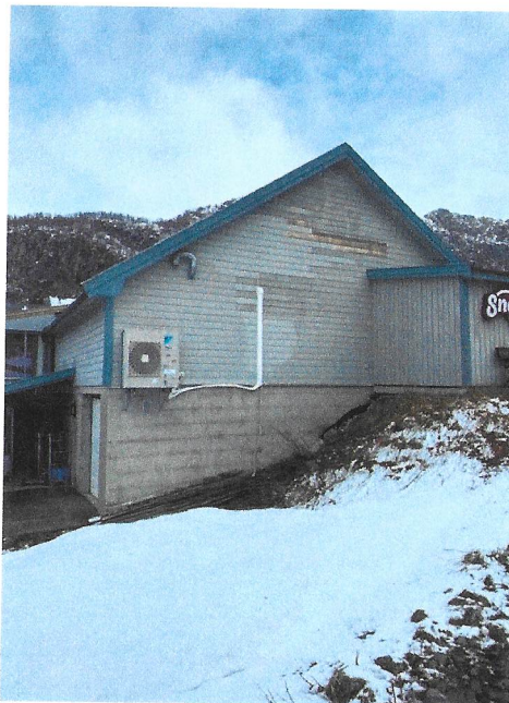
Eksempel på dårlig kledning i gavlen.
