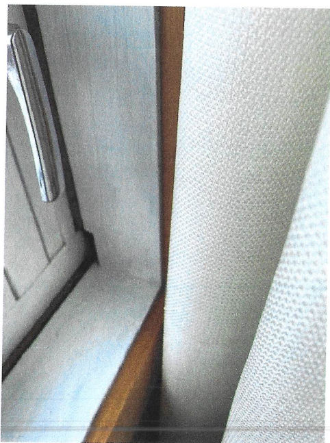
Løs foring på vindu i møterom.
