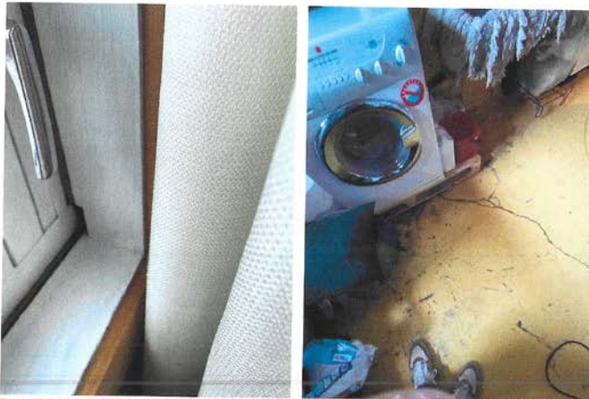
Løs foring på vindu i moterom. Vaskerom med sprekker i gulv. Gulv er ikke vanntett.
