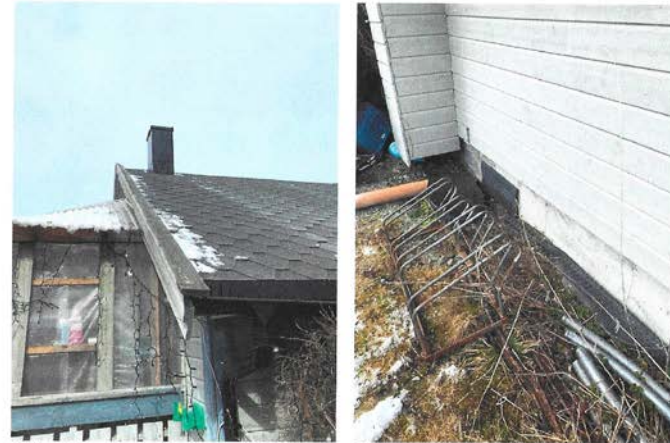
Taktekking, vannbord og vindskier. Ufagmessig bygd tak over veranda.
