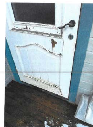
Eksempel på dårlig dør.
