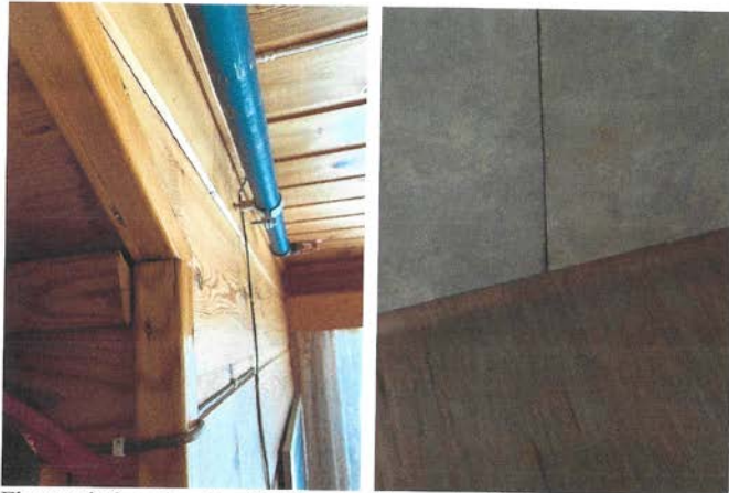
Eksempel på merker etter fukt i panel. Eksempel på fuktskade i baderomsplate i dusjen.
