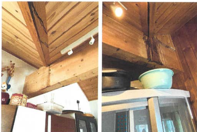
Begge bilder viser lekkasje av kondens i takkonstruksjonen. Henholdsvis på kjøkken, bilde til venstre, og på bad.
