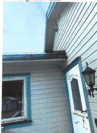
Eks på manglende takrenne
