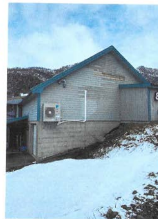
Eksempel på dårlig kledning i gavlen.
