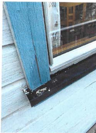
Eksempel på dårlig kledning og belistning rundt vindu
