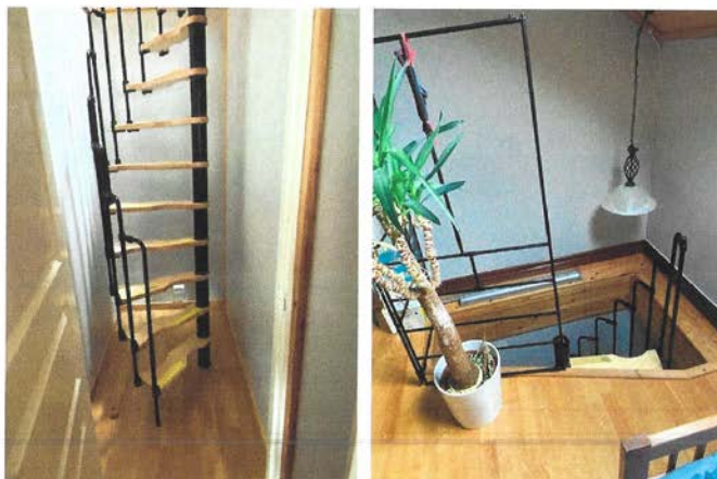
Bratt vindeltrapp med ikke godkjent rekkverk i trapp eller på toppen av trappen.
