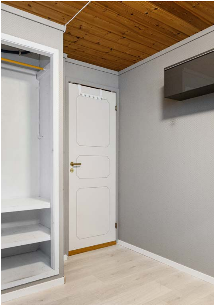
Bod/disponibelt rom brukt som soverom i underetg. (ikke godkjent til varig opphold)
