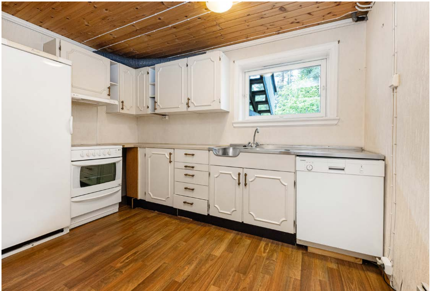
Matbod er omgjort til kjøkken. Vindu er byttet. Rom er ikke godkjent til varig opphold.
