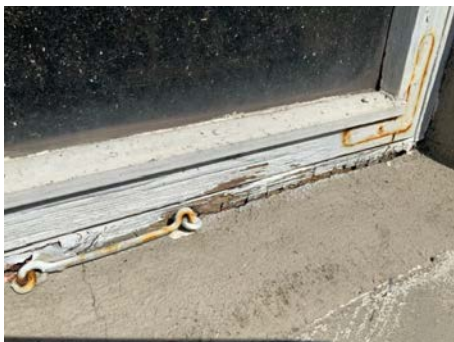
Råteskadet vindu. Rust på utvendige beslag.
