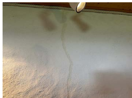
Sprekk i innvendig murvegg
