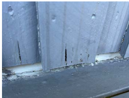
Eksempel på spredte råteskader
