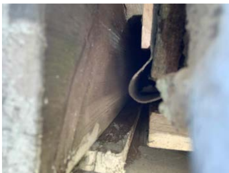
Svakheter i musetettingen bak kledningen.
