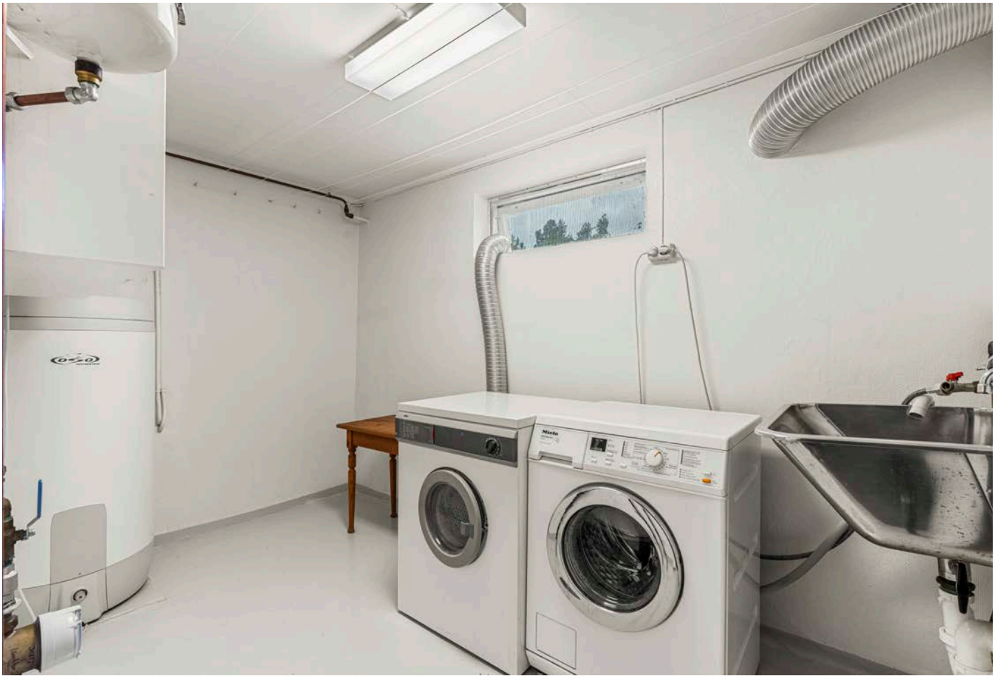
Vaskerom med varmtvannsbereider
