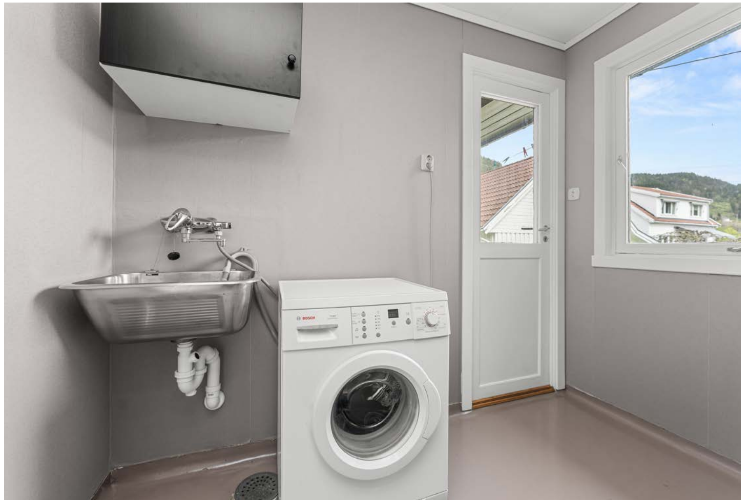
Vaskerom med utgang.
