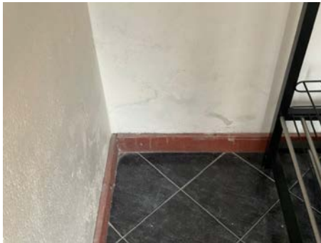
Litt saltutslag kjeller.
