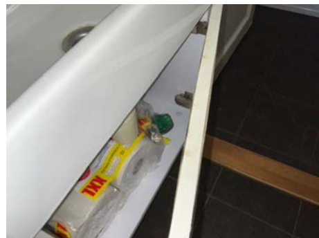
Fuktsvelling i dør til innredning
