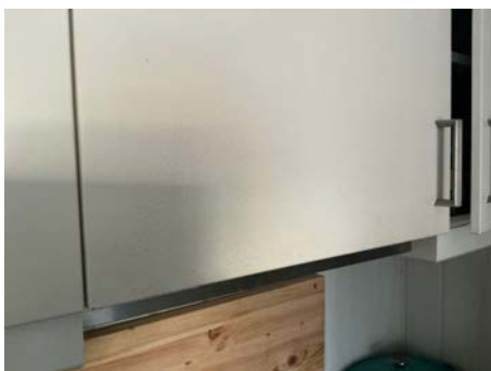
Ikke enkelt å se på bilde, men fuktsvelling front over steketopp.
