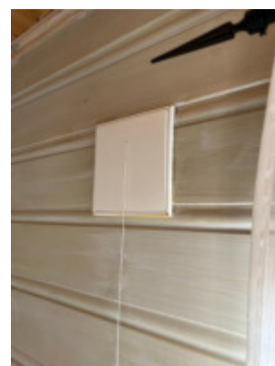
Eksempel på montert ventil i vegg.
