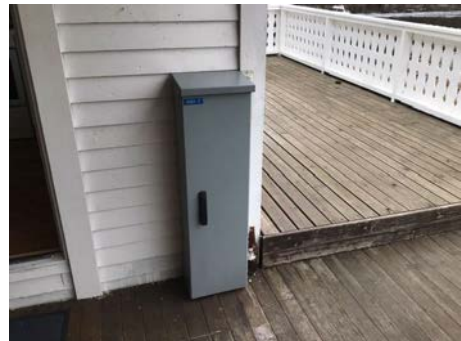
Utvendig inntak på strøm.
