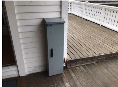
Utvendig inntak på strøm.
