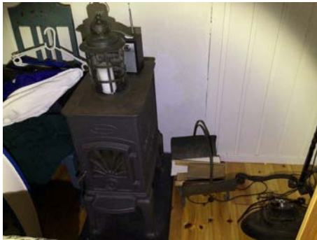
Montert ovn i soverom.
