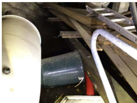
Er ser mann stående vann under hytten.
