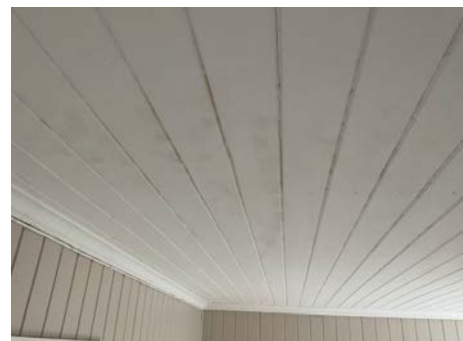
Bilde viser eks. på fuktskjolder på takpanel i 2. etasje
