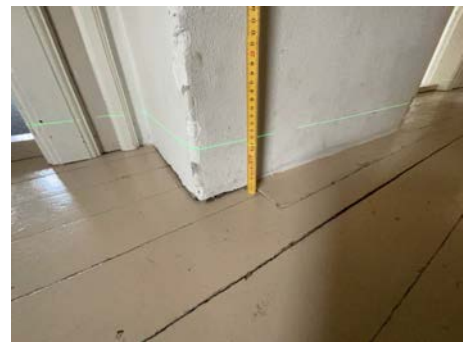
Utkastrek på laser er 11 cm på målestokk. Bilde viser ca. 25 mm høydeforskjell innenfor 2 meter i gang 2. etasje.
