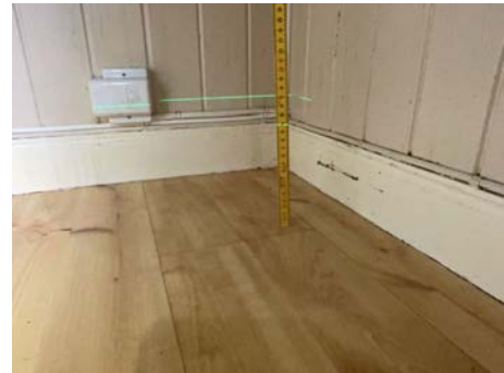
Utkastrek på laser er 11 cm på målestokk. Bilde viser ca. 30 mm høydeforskjell innenfor 2 meter på kjøkken.
