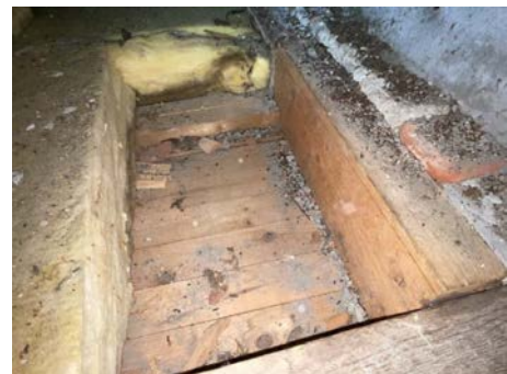
Ingen synlig dampspærre under isolasjon på kaldtloft
