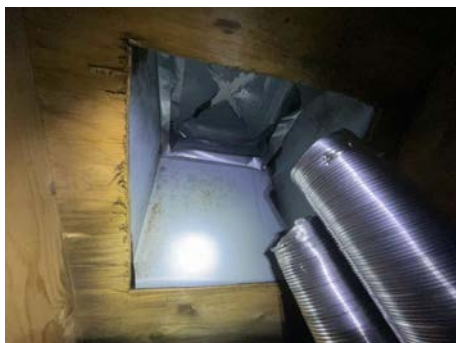
Ventilhetten med avkast fra toalettrom og bad.
