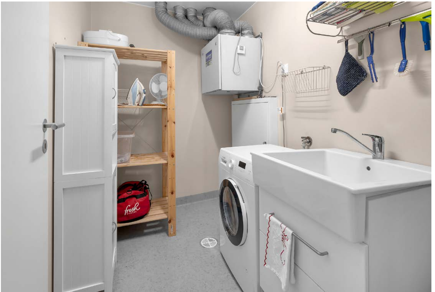
Vask/teknisk rom med ventilasjonssystem og opplegg til vaskemaskin.
