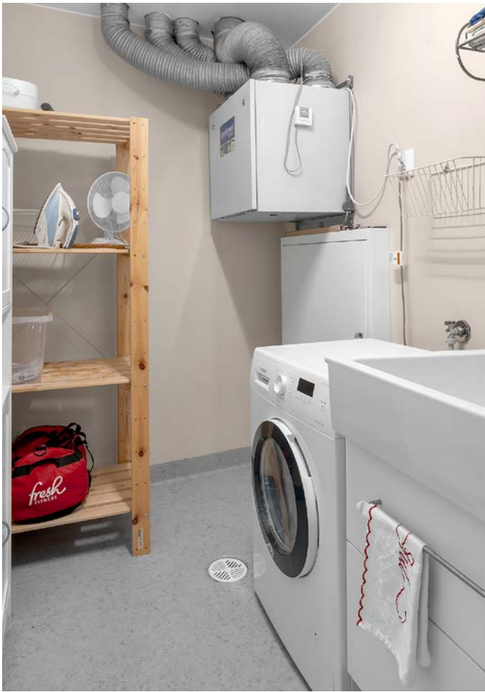
Vask/teknisk rom med ventilasjonssystem og opplegg til vaskemaskin.
