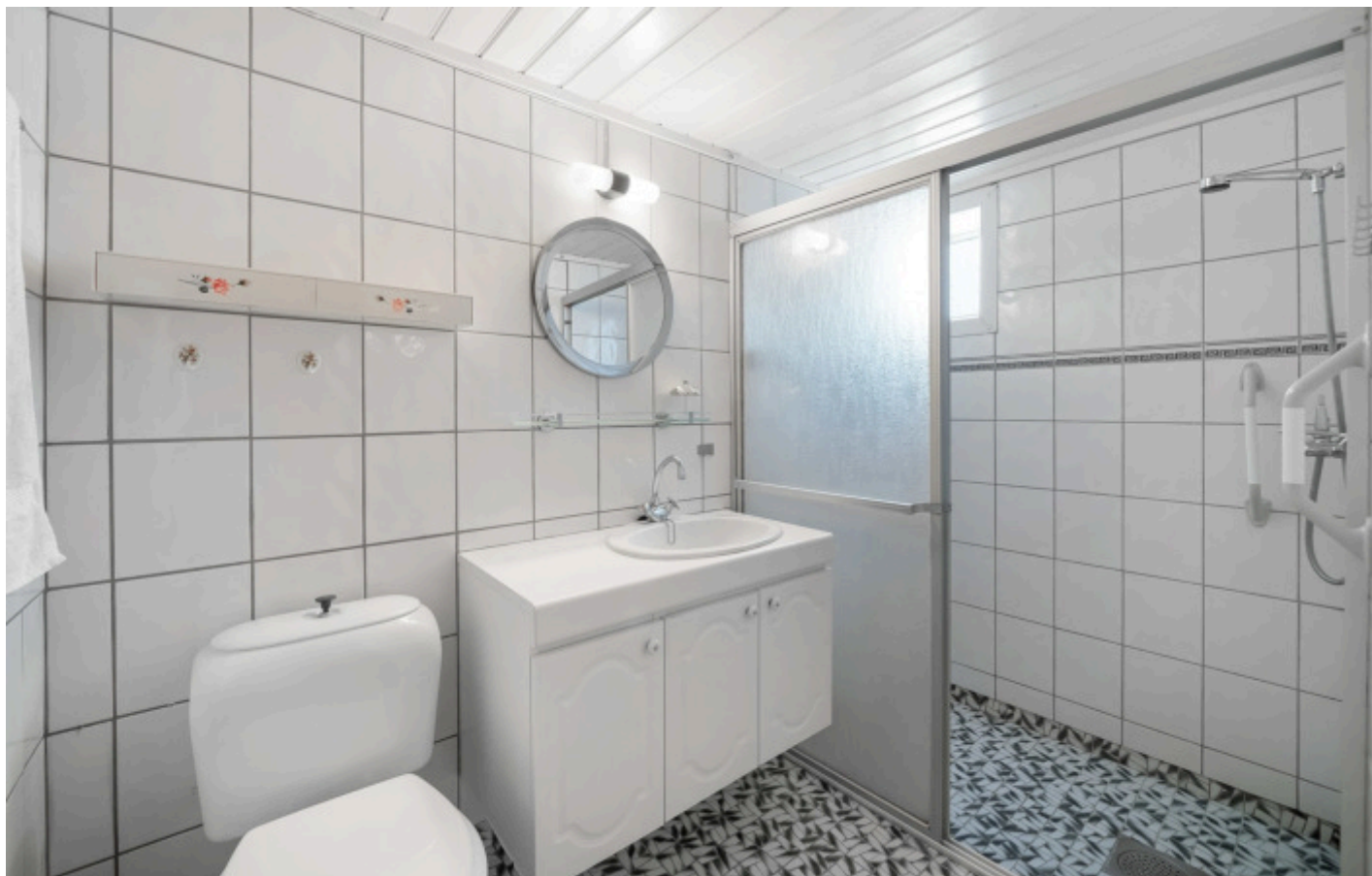
Bad i kjelleren med fliser på gulv og vegger. Varmekabler i gulv. Innredet med baderomsinnredning,toalett og dusjløsning.
