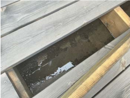
Stedvis lite/ikke fall på underliggende tekking så vann ligger igjen.
