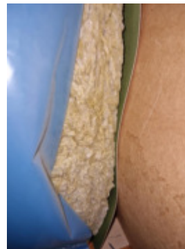
Sammenklemt luftespalte sett fra kott.
