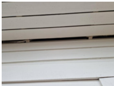
Varierende bredde spalte gesims på grunn av skjevhet.
