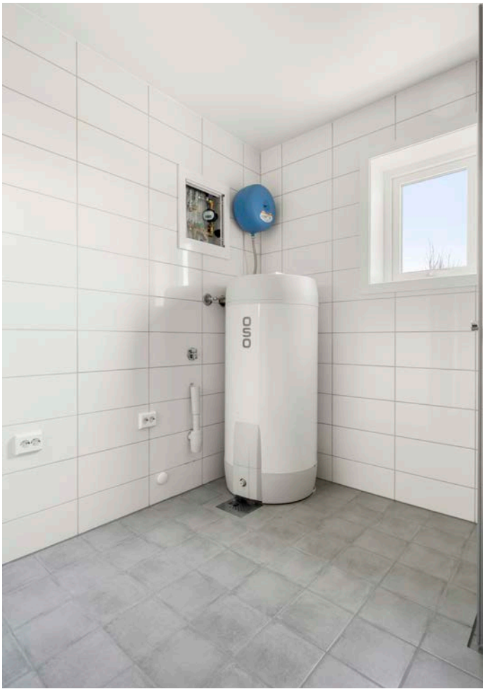
Varmtvannsbereder og plass til vaskemaskin og tørketrommel på badet
