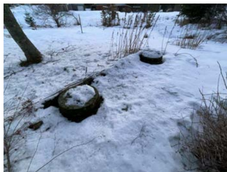
Septiktanker i betong, lokalisert i hage.
