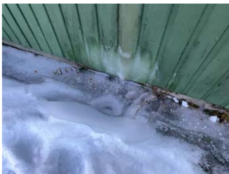
Vann som fryser på vegg fra pumpe.
