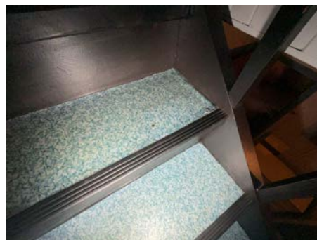
Små hull i trinn og belegg.
