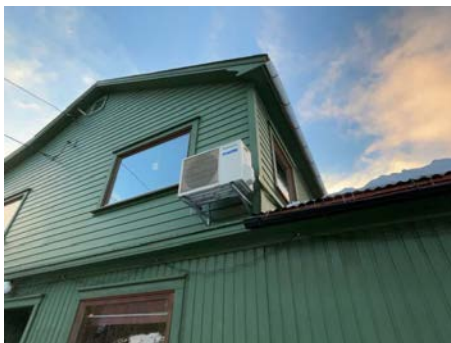
Varmepumpe, utvendig aggregat.
