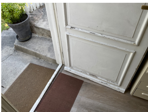
Inngangsdør. Værslitasje og utett mellom karm og dørblad.
