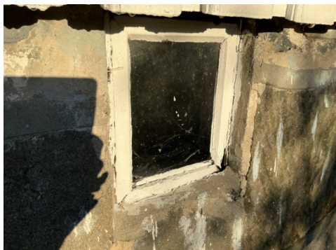
Eldre vindu kjeller, råte i karm etc.
